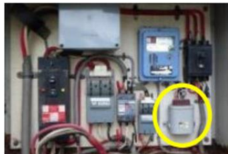
低圧分電盤内の低圧コンデンサー
