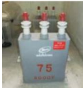
電力用コンデンサー
