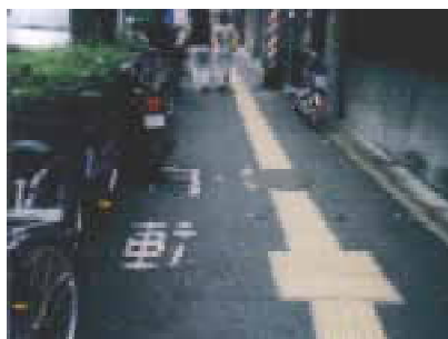
消えかけた歩行者・自転車分離標示の改善（国道）
