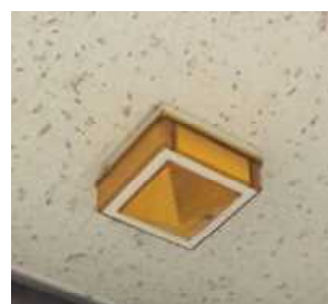
トイレに設置された緊急事態を知らせるランプ
