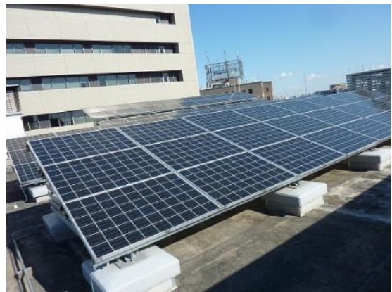
太陽光発電パネル(本庁舎)
