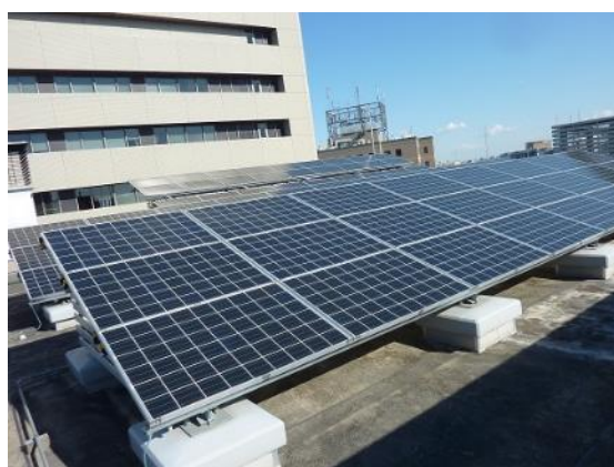
太陽光発電（本庁舎南館屋上）
