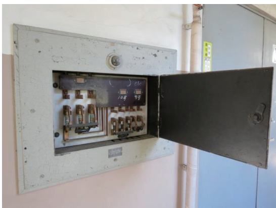
〔図 38〕 分電盤 昭和 16 年 10 月製造
