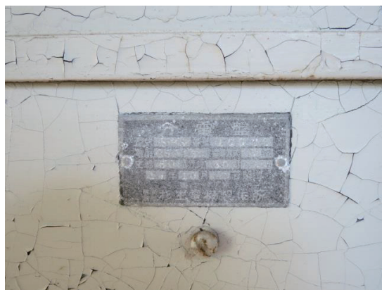
〔図 39〕 分電盤 昭和 16 年 10 月製造
