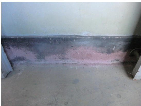
〔写真 39〕 E棟巾木
