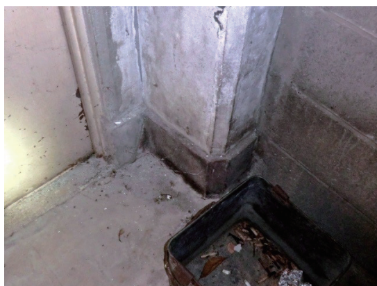
[写真 23] 廊下と宿直室壁面出隅部
