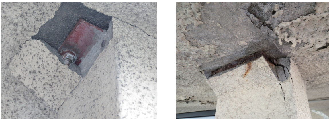
〔写真3〕ポーチと庇との取り合いの仕上げ欠損部分
