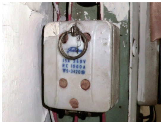
〔写真 42〕 陶器製ブレーカーヒューズボックス
