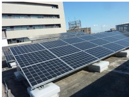
太陽光発電パネル(本庁舎)
