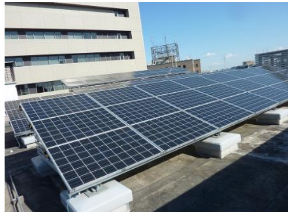
太陽光発電（本庁舎南館屋上）
