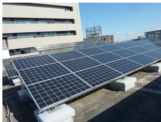
太陽光発電パネル(本庁舎)
