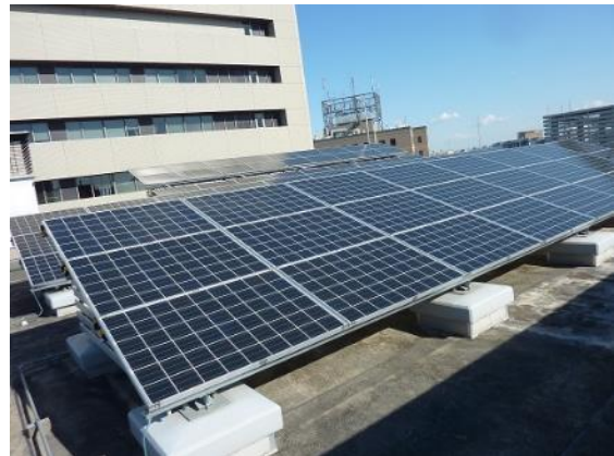
太陽光発電（本庁舎南館屋上）
