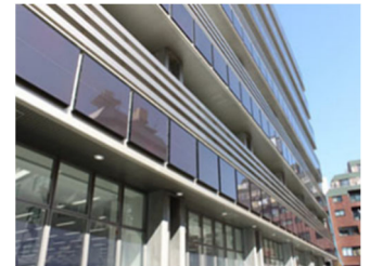
太陽光パネルを屋上と壁面に設置 (本庁舎南館)
