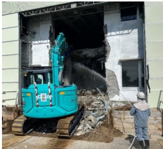
散水状況の例
