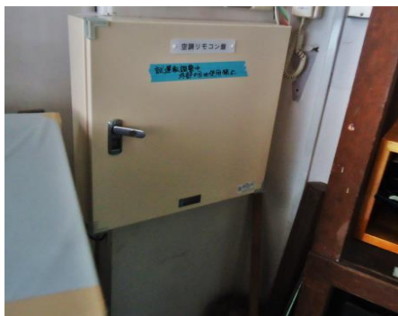
(空調リモコン盤)
