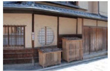
室外機を竹などの自然素材で修景した例（他都市）
