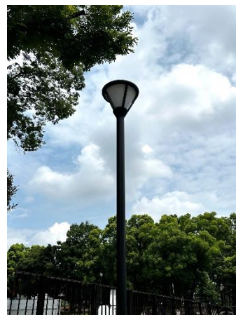
LED 化された公園灯
