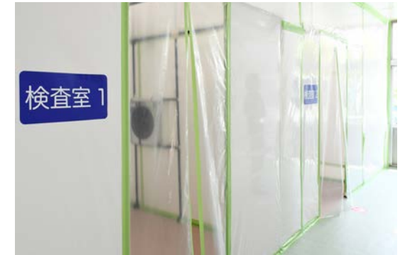
【写真2】ビニールカーテンで仕切られたHEPAフィルタ付簡易陰圧室構造の検査室
