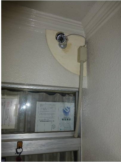
防犯カメラの設置
